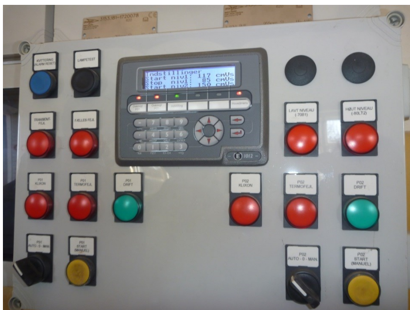
Figur 4. Anlæg for pumpestart og -stop samt fejlmelding af system- eller pumpefejl.
