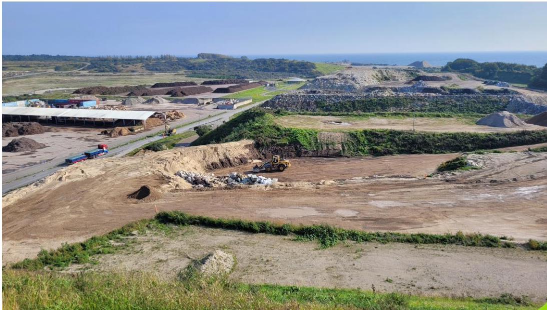
Kig ned i asbestenheden, hvor asbest er under afdækning
