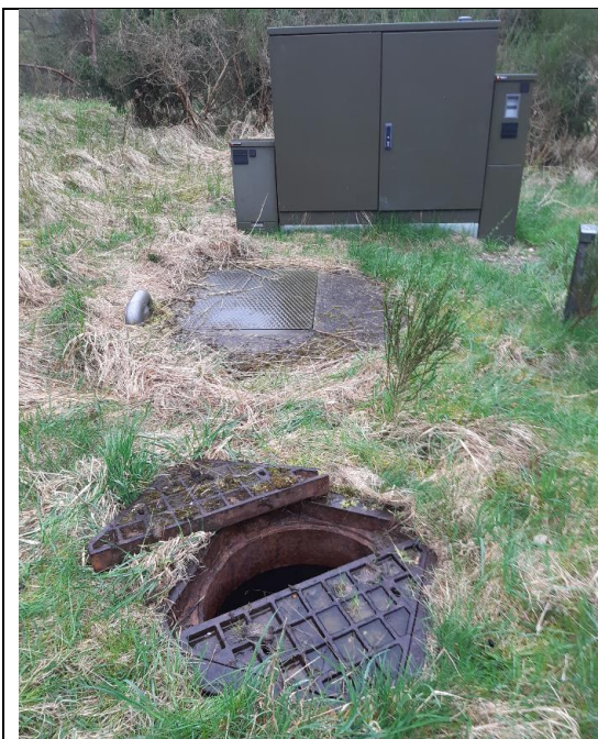
Billede 1. Pumpebrønd m.m. til perkolat.
