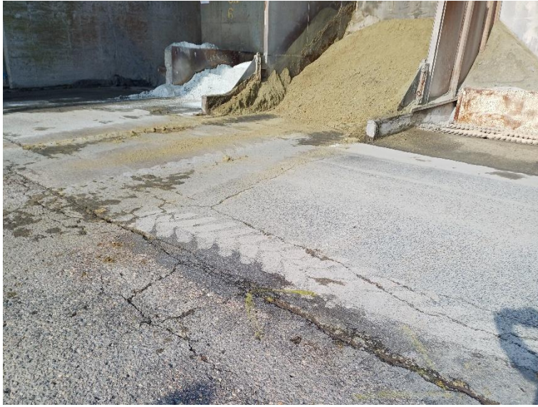
Billede 4: Oplag af stangmølle. Belægning ved oplag er revnet.
