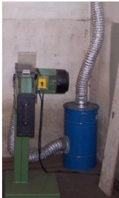
Udsugning fra båndsliber med støvfilter
