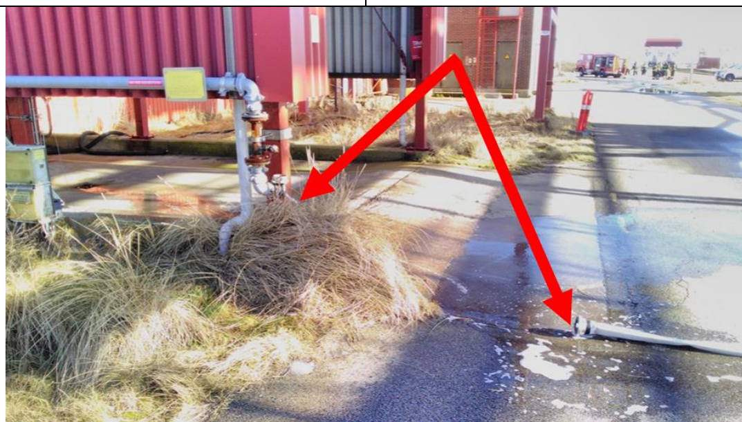
Billede 3. Udtømmning af skumvæske på befæstet og ubefæstet areal fra brandslukningsudstyr, herunder det faste anlæg på PMP og brandstationens slanger, efter afslutning af øvelse.
