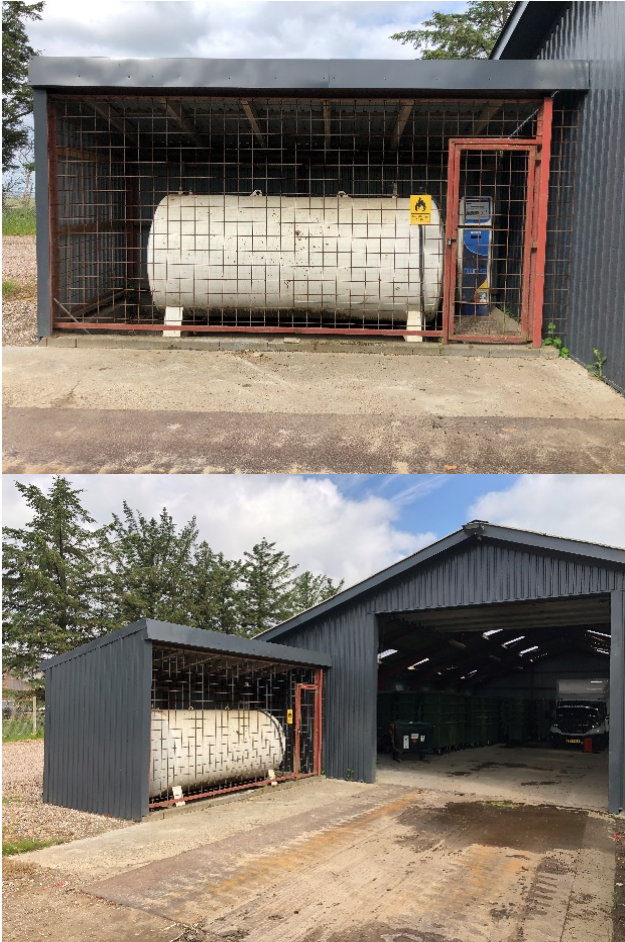
Foto 29-30: Dieseltank og tankningsplads.
