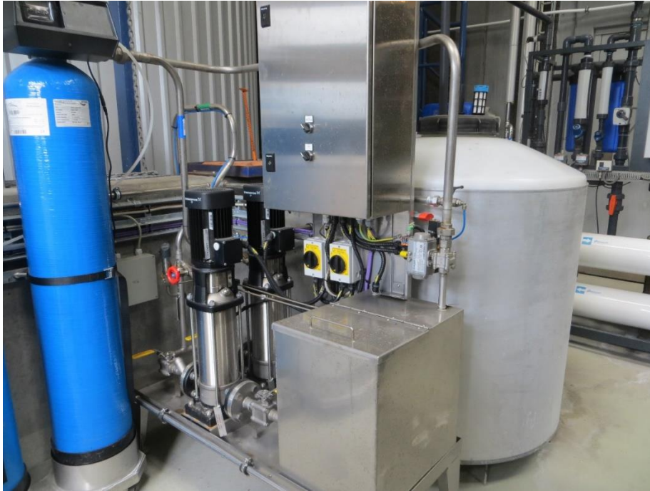
Ammoniakvand opblandes igen med demineraliseret vand inden indysning i efterforbrændingskammeret.
