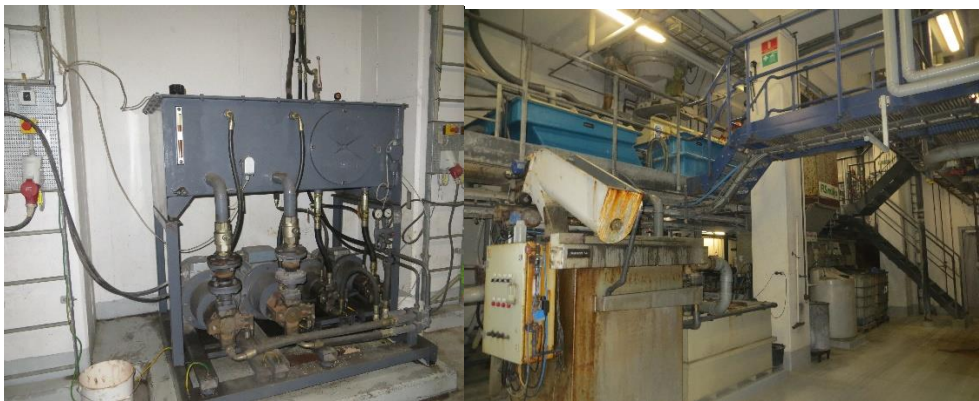
Til venstre; motor med integreret olietank i kompressorummet. Til højre; slamtørring og renseanlæg til spildevand fra røggasrensning
