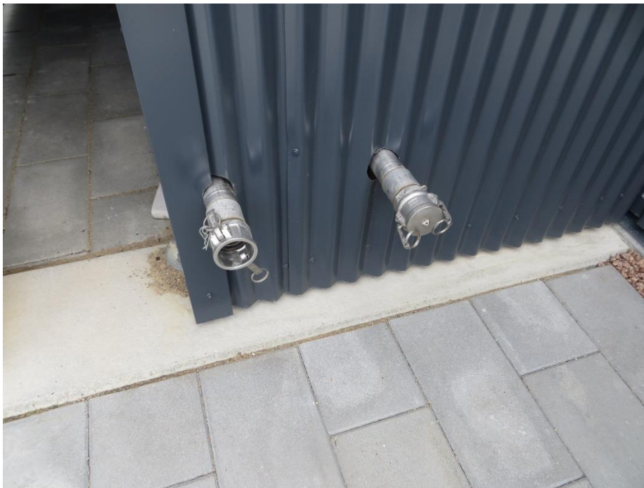
Udendørs del af DeNox anlæg; Ammoniakvandstank, styringstavle, pumpe og påfyldningsstuds.
