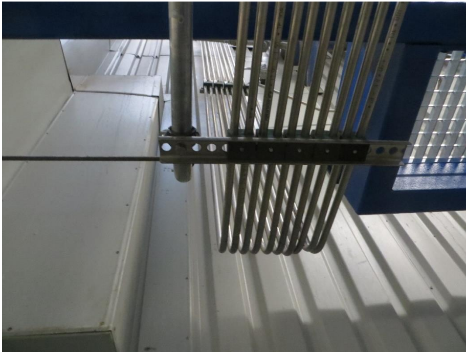
Dyser til ammoniakvandsdoseringen i efterforbrændingskammeret.
