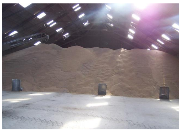
Lagerhal fra 1991 på 1.262 m 2 (BG 4) Opmagasineret af korn. Beluftsblæsere.
