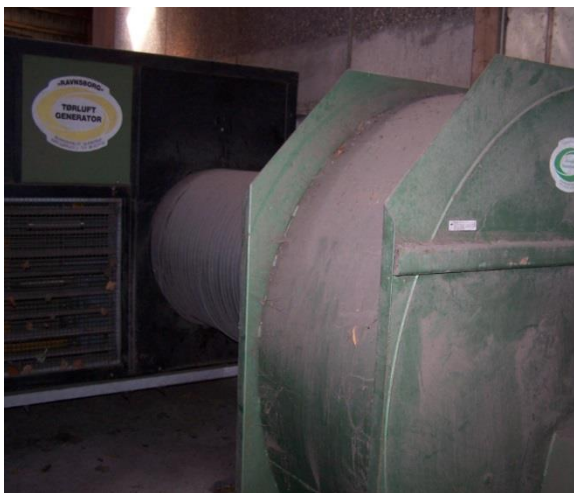
Beluftsblæser med fugtreducering i hal 4
