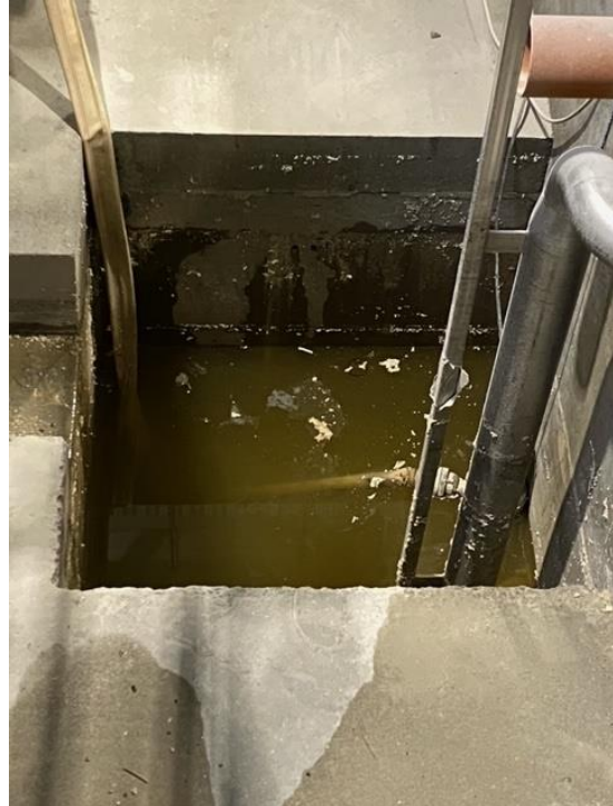
Spildevandssump på ca. 2 m 3 , som tømmes med dykpumpe
