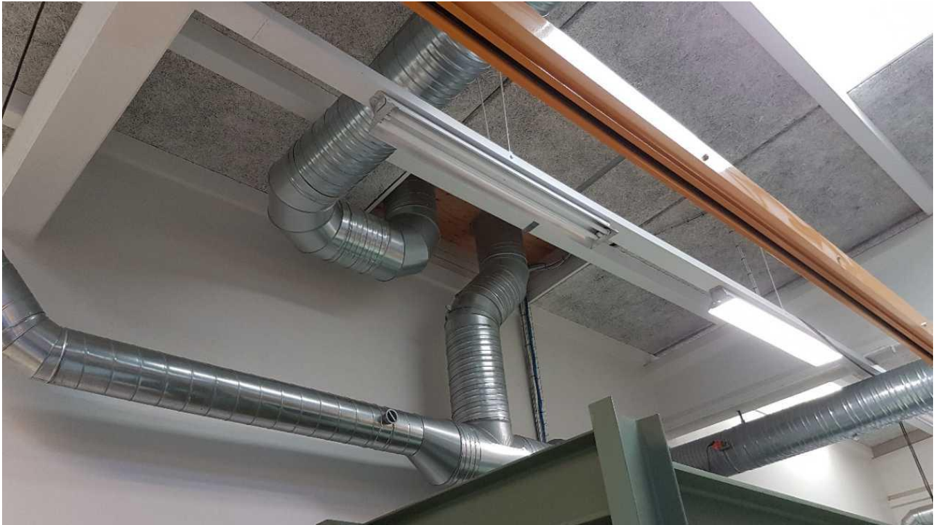
Røret til venstre er samlet afkastør fra støbebordenes undersug. Røret til højre er friskluftindtag til produktionshallen.
