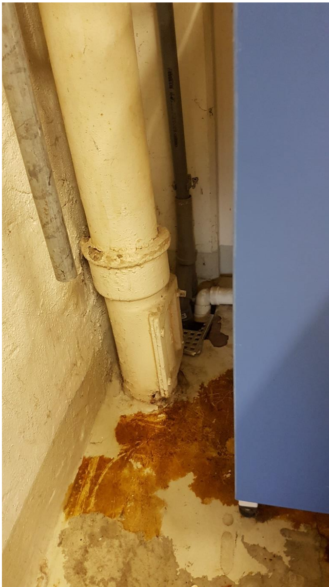
Gulv afløb i hjørnet af produktionshallen, hvor der oplagres isocyanat og polyoler.
