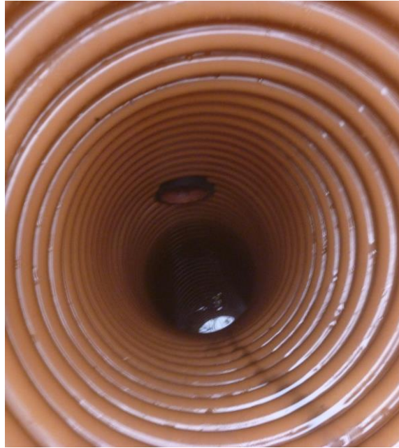
Billede 4. Perkolatbrønd mod syd uden afpropning.
