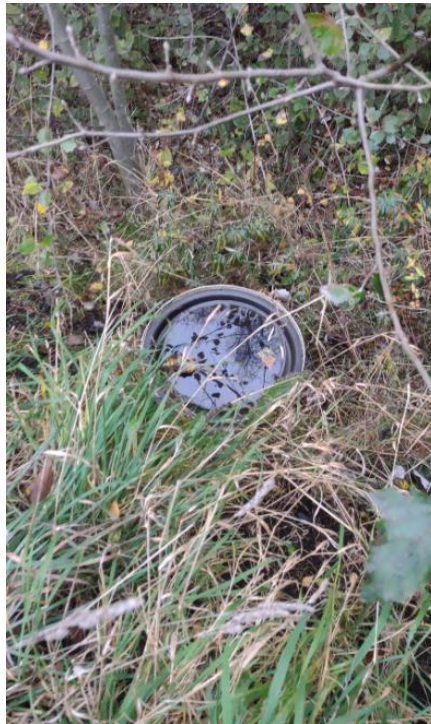
Billede 6. Perkolatbrønd mod øst med afpropning.
