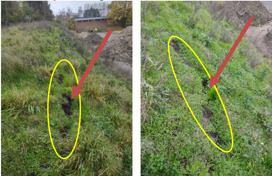
Billede 2. Synlige skred i slutafdækningen på depotets vestlige side.
