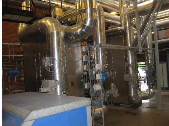
To af varmeværkets vekslere
