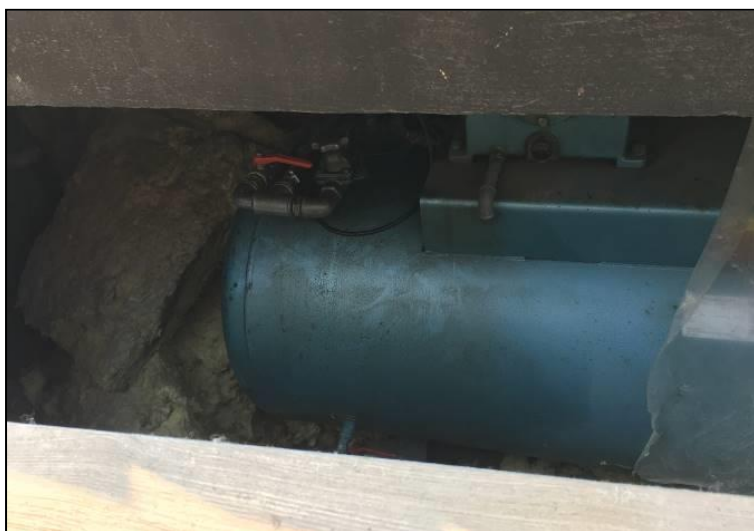
Kompressortank i aflukke
