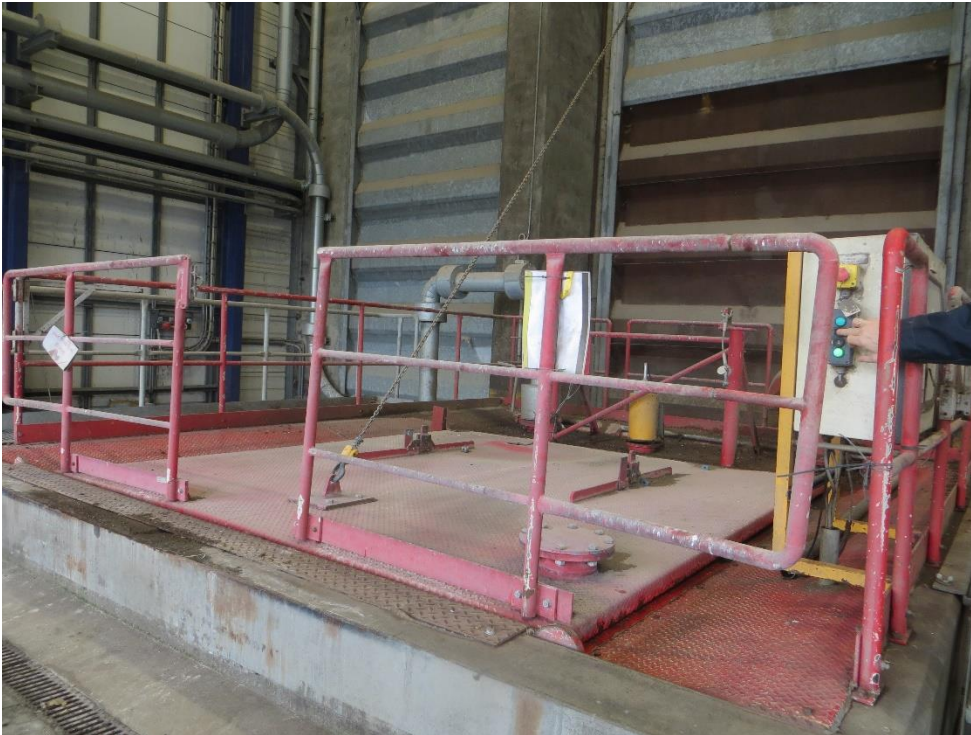
Modtageanlægget til slam. Slammet pumpes ind i forbrændingssovnene
