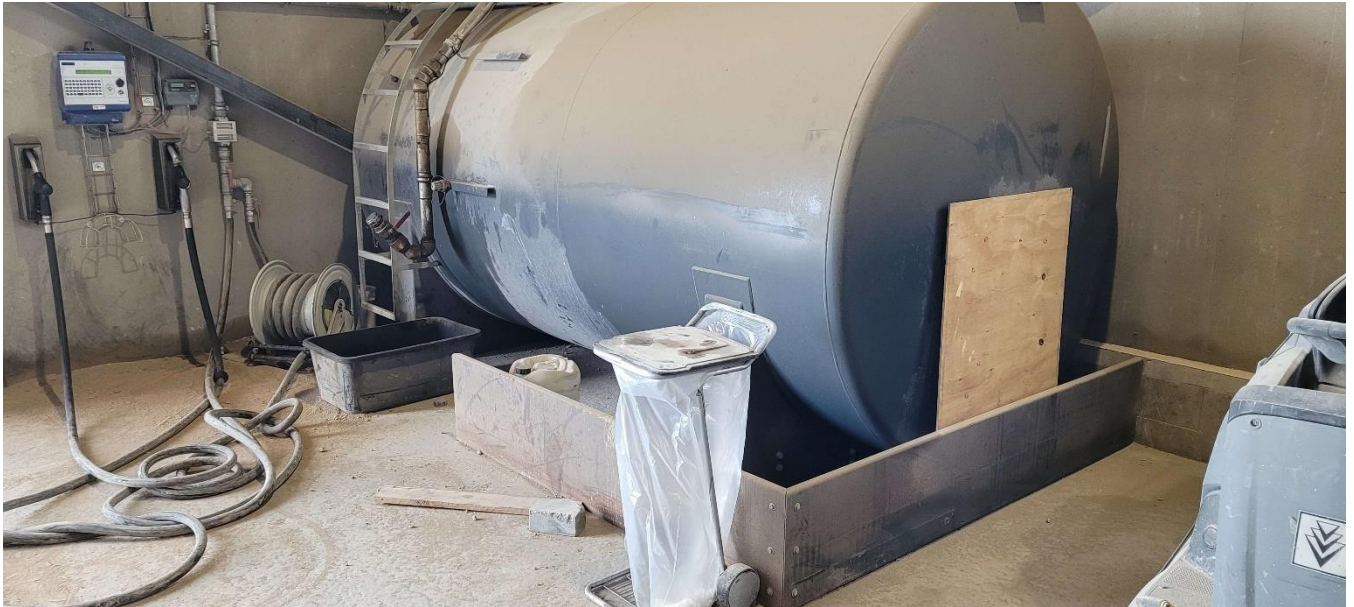
Olietanken er beskyttet mod påkørsel ved metalsider, som er boltet i betongulvet.
