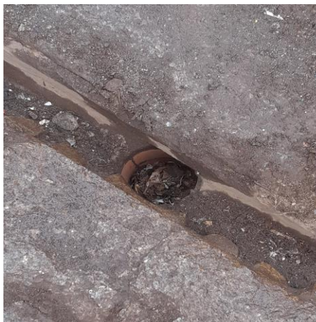
Delvist tilstoppet afløb ved renden på havnekajen
