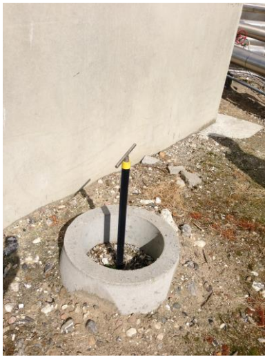
Tankgårdsventiler tilknyttet alle tankgårde.
