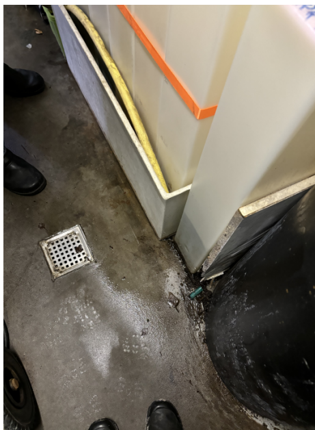
En beholder med vaskekemi tæt på gulv afløb
