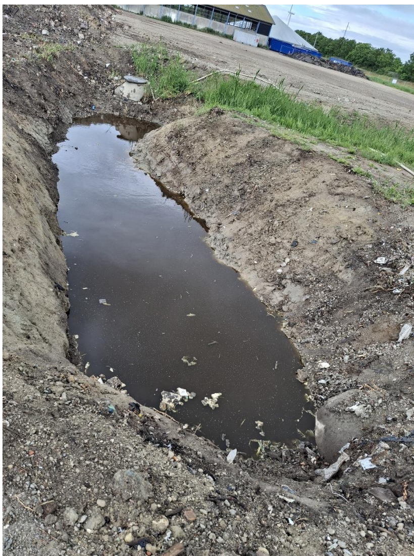
Figur 21. Perkolatpåvirkning i udgravning ved samlebrønd fra den tidligere affaldshåndteringsplads.
