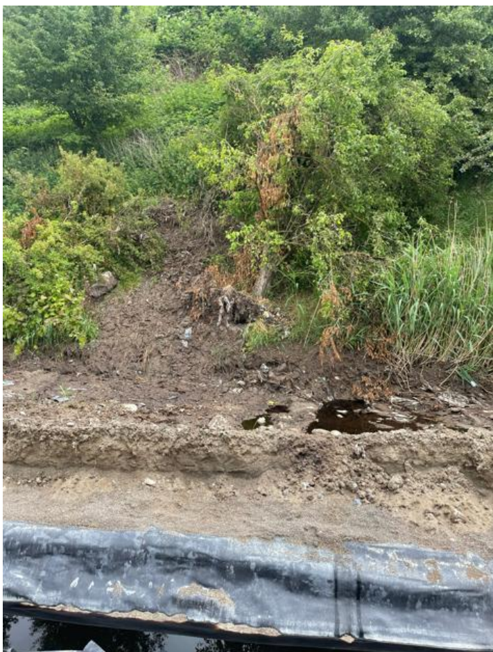
Figur 26. Perkolat ses i udskredet del af celle 1, som ligger over membranvold.
