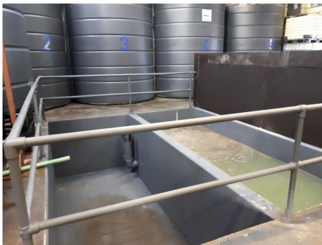
Udløbstanke med beholdertanke i baggrunden
