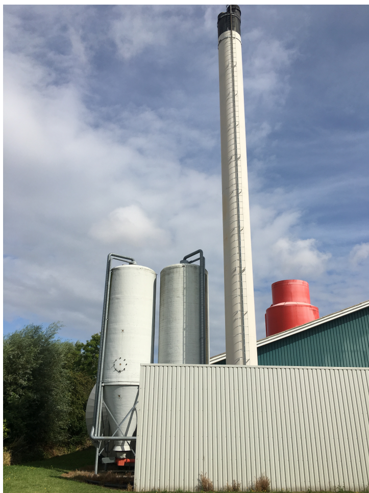
Siloer til træpiller etableret i 2012
