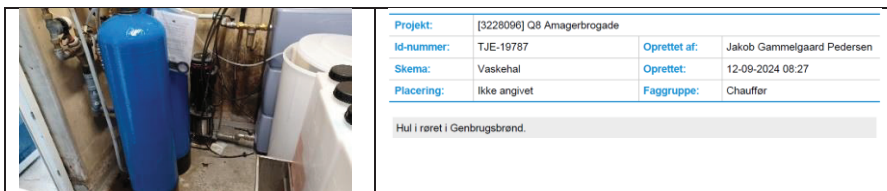
Ionbytter og brønd til genbrugsvand.
