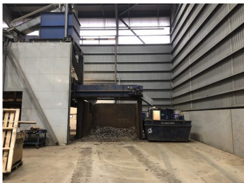
Metalsorteringsanlæggets bånd til output. Ren rustfri fraktion i båsen til højre. Fraktion til gensortering til venstre i blå container. Bag støjisolering sorteres dele fra fraktionen manuelt, fx printplader.
