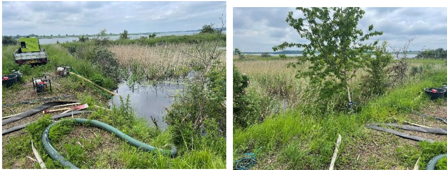
Niveau tydeligt højere i afsnit 2 end 3. Overpumpning via dieselgenerator
