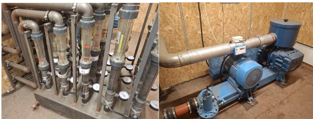
Figur 11 Indenfor i containeren med pumper til boringerne
