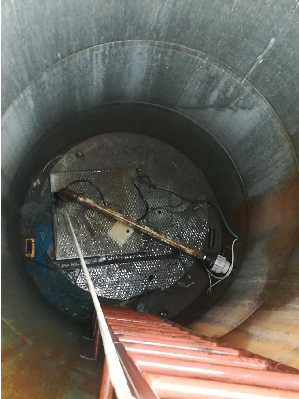
Fig. 2 Perkolatbrønden – Tilsynsførende kunne ikke høre at pumpen var aktiv. Pumpen burde starte automatisk, når vandstanden når en indstillet højde.
