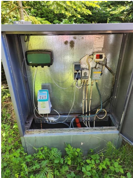
Foto 4: Det indre af styringsskabet mod nord ved PB1. Perkolatpumpen kan tvangsstartes ved at trykke på den røde knap.
