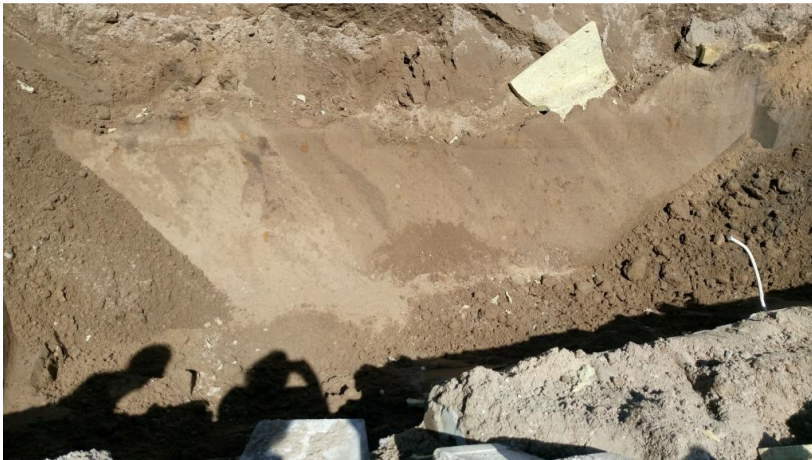
Jorden under olietanken efter opgravning.
