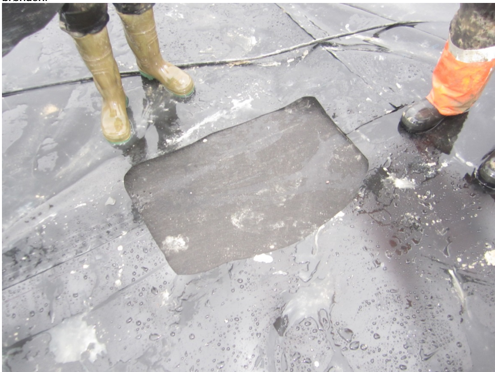
Foto 12 Udtaget prøve til kontrol af svejsning. Udtaget i det nordøstlige hjørne lidt syd for perkolatbrønden
