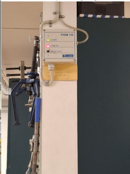
Alarm på udsugning
