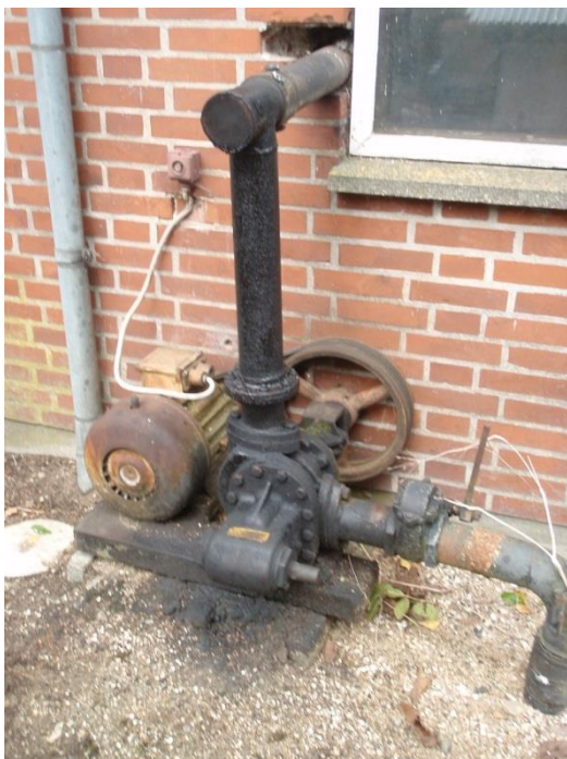
Rør/pumpe til spildolie. Tilsyn, 2013
