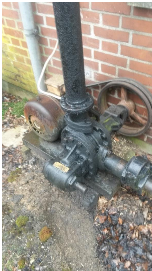
Rør/pumpe til spildolie. Tilsyn, 2016
