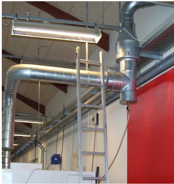
Olietågefilter på et udsugningsanlæg med aftapning via slange i bunden
