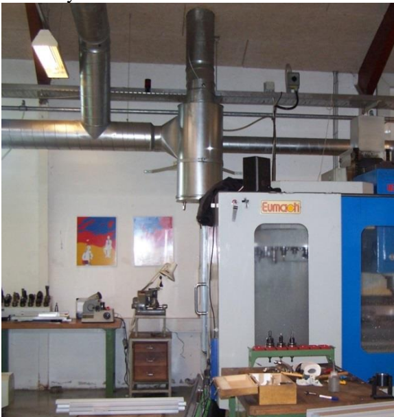
Olietågefilter på udsugningsanlæg
