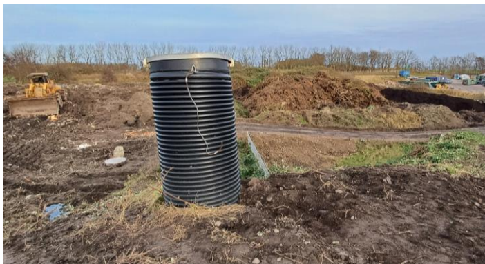
Brønd 6 (og brønd 7 nedenfor til venstre)
