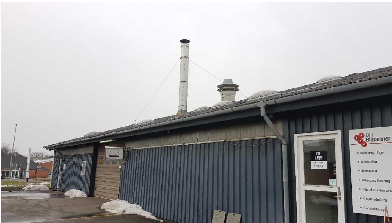
Skorsten fra oliefyringsanlæg.
