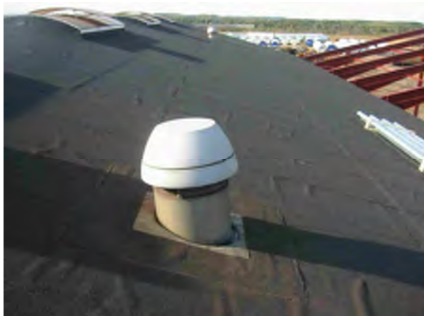
Små ventilatorer. Støjkilde 21
