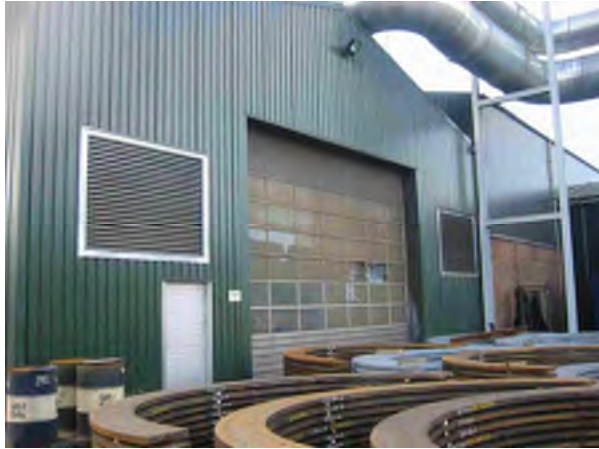
Riste + port i hal 7. Støjkilde 13+14
