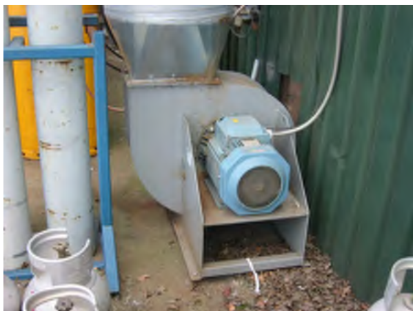
Ventilator ved hal 3. Støjkilde 16
