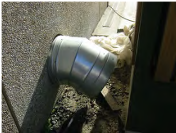
Udblæsning ved hal 24. Støjkilde 18
