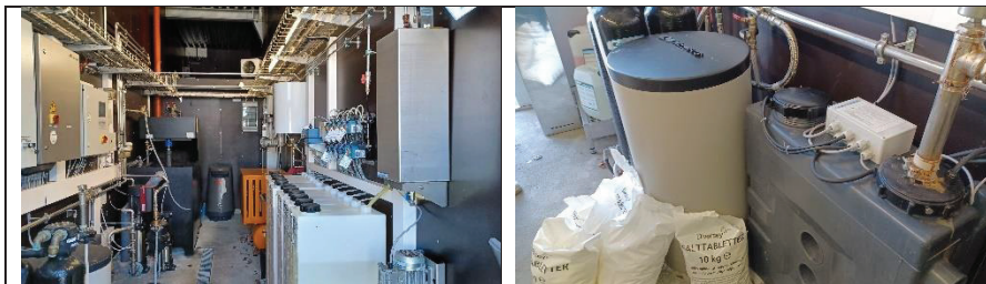
Ionbytter og vaskemidler placeret på spildbakke
