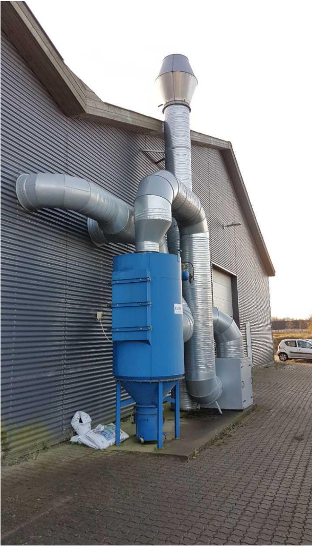
Filteranlæg med afkast fra svejsning og slibning.
