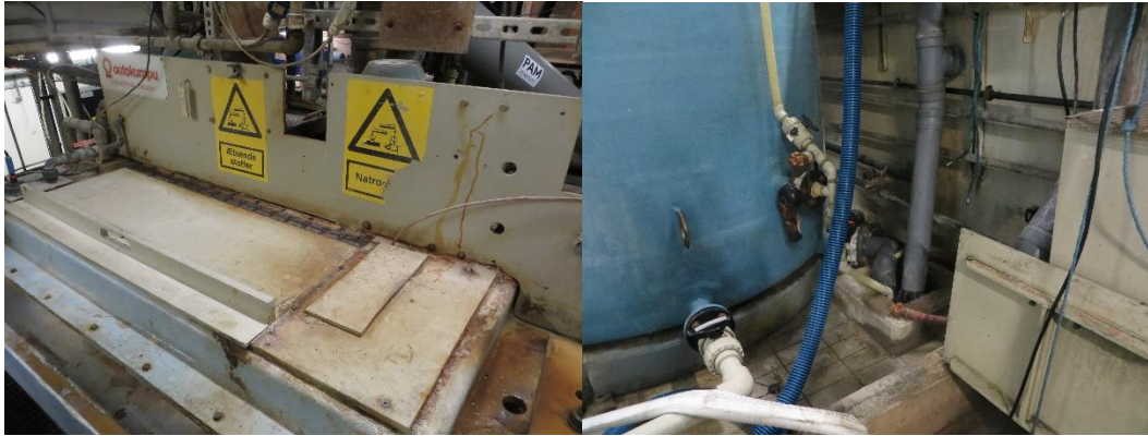
Dele af installationerne i renseanlægget.
