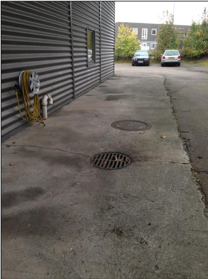
Foto 10: Sandfangsbrød og Olieudskiller
