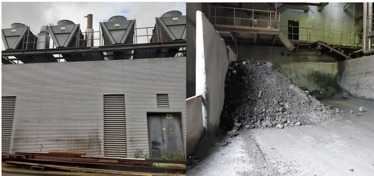
Figur 4 – tv. Afkast fra den store diesel-nødgenerator er placeret på den ca. 6 meter høje bygning; th.: Hal til slaggeopsamling
