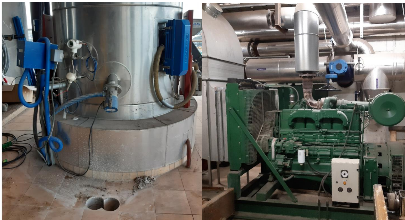
Figur 3 – tv. forberedelser til nye målere på ovnlinje 5. t.h. lille diesel-nødgenerator.
