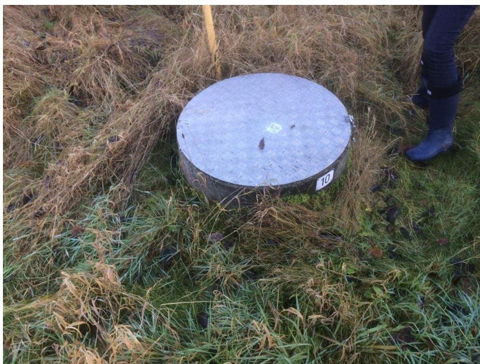
Brønd B10, hvor overfladevand fra indkørslen opsamles.
