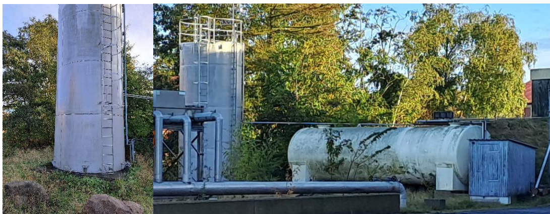
Figur 2 og 3 - Ammoniaktank til venstre og Dieselolietank til størrebrændere til højre.
