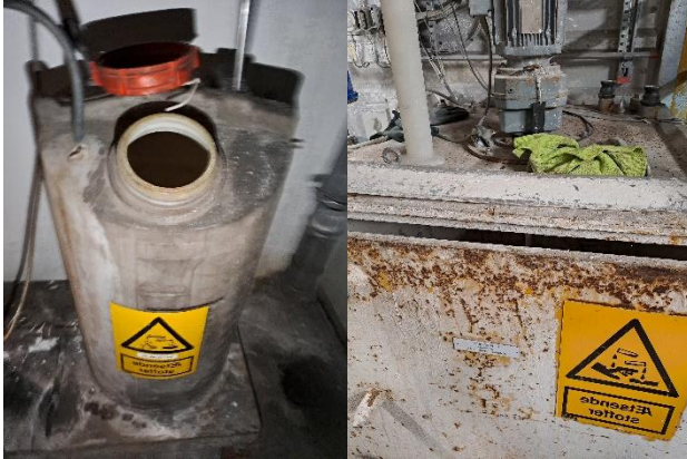
Figur 7 og 8 - tv. beholder til natriumhydroxid og th. blandingstank til kalk
