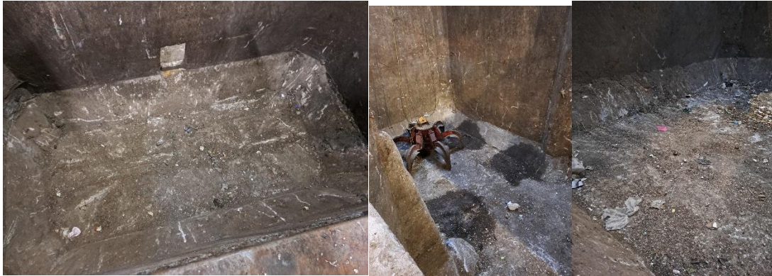
Figur 20, 21 og 22 - affaldsiloer blev besigtiget og disse fremstod tømte. De våde pletter på det midterste billede skyldes formegentligt tre manglende ovenlyskupler i taget
