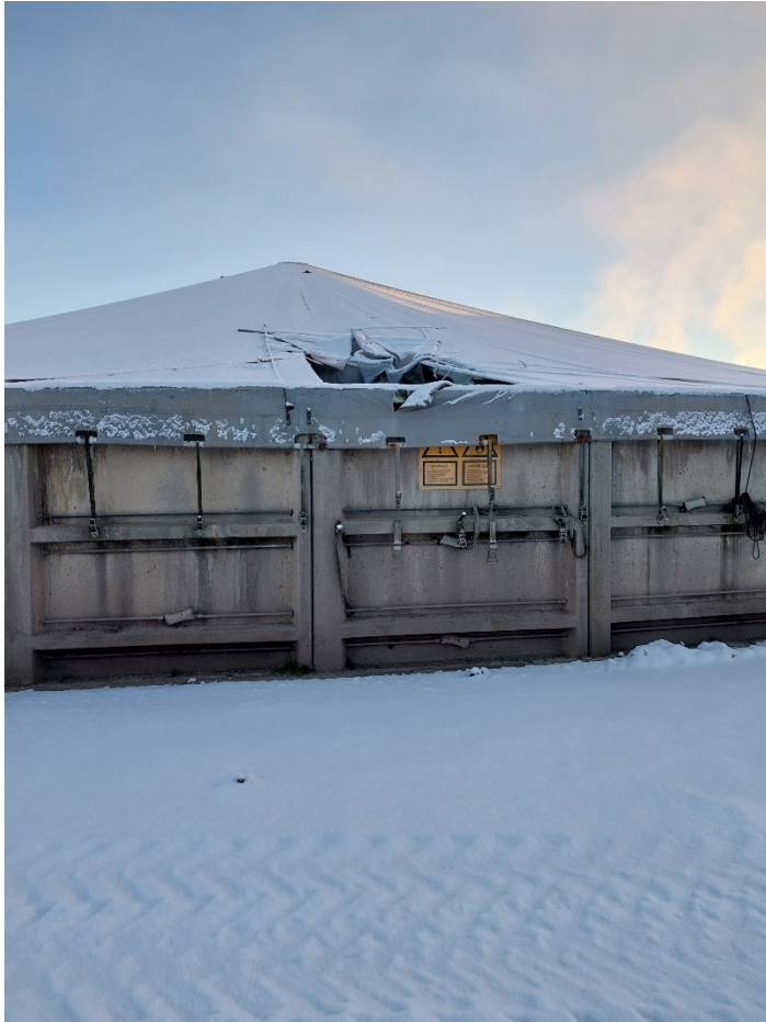
Teltdug med skade
