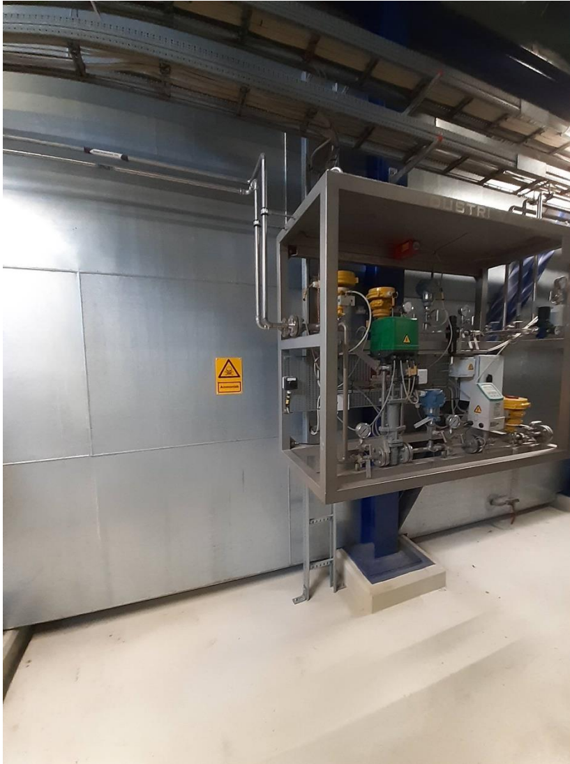
DeNOx-anlæg til gasturbine
