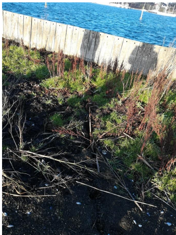
9. Revne i jorden ved anker/wire ud til spuns
