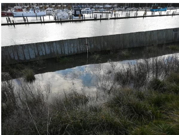
26. Sydlig træspuns. Revne i spuns, vand trængt ind mellem spuns og dige
