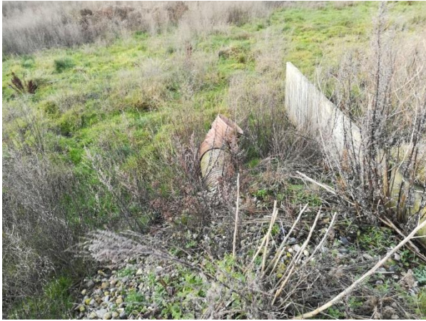
21. Rørende inde på deponi (til overfladevand)
