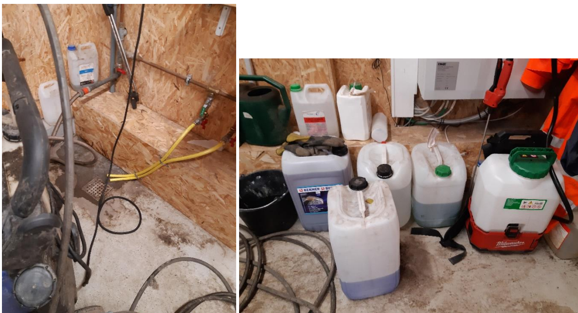
Figur 2: Foto til venstre: Afløbsrist i værksted placeret i gulvet imellem stålvaske og udgangsdør mod vest. Foto til højre – udvalg af kemikalier oplagret til højre for stålvaske i værksted.
