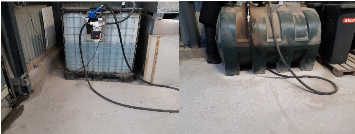
Figur 3: AdBlue-tank og brændstoftank placeret mod vestvæg i den sydlige del af hal. AdBlue-tank umiddelbart inden for portåbning. Brændstoftank var jf. tankskilt: Harlekin, type HZ, 1400 L, fabrikationsår 2008, G. nr. 1-5820, nr. H2993.
