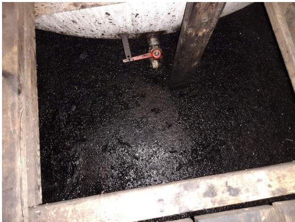
Figur 7: Tilsværtet bund af betonkar i olieskur.
