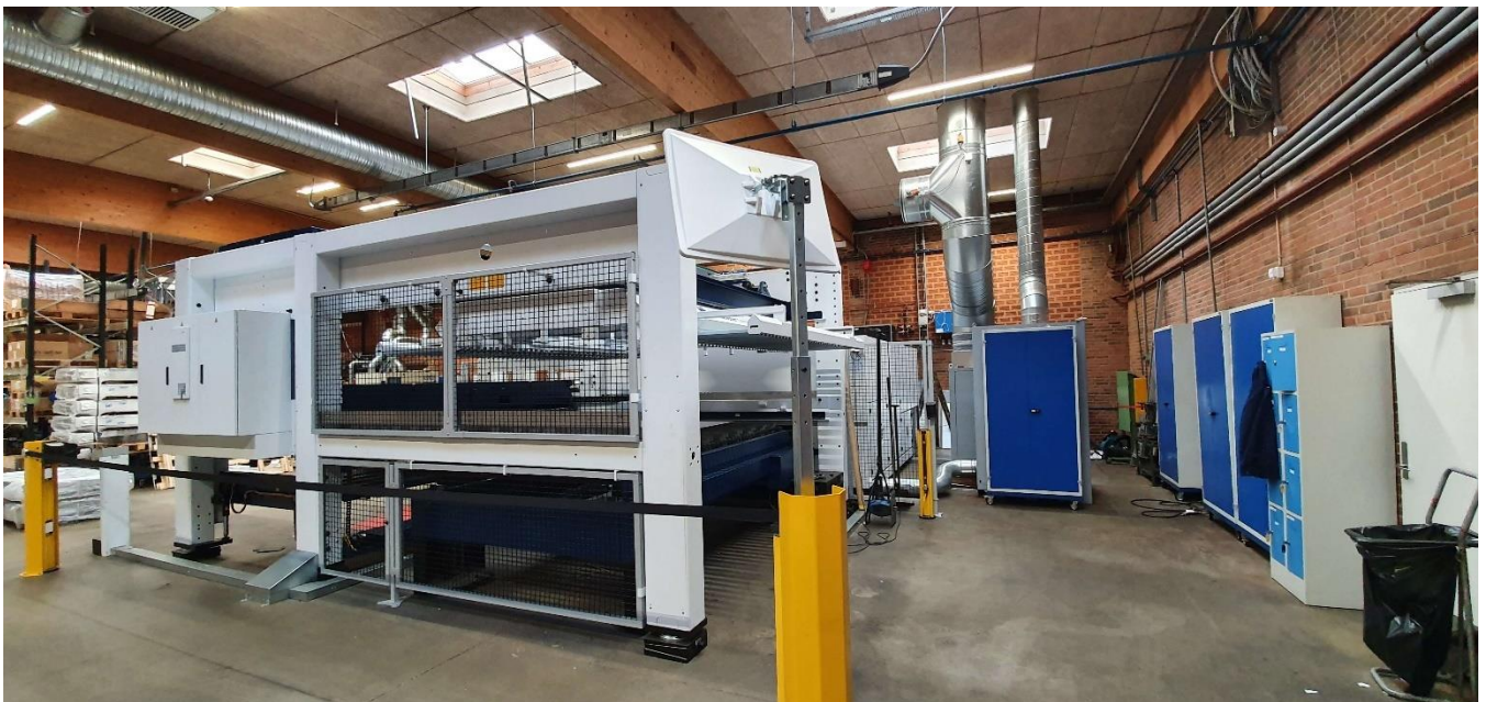
Ny fiber laserskærer med nyt filteranlæg.
