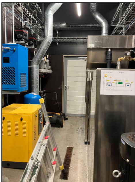
Teknikrum med afløb
