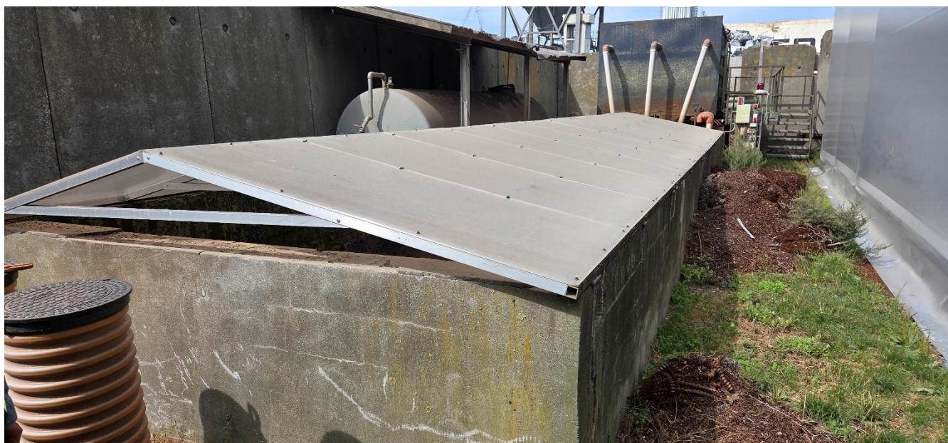
Stenfilteret er blevet overdækket siden tilsynet i 2024.
